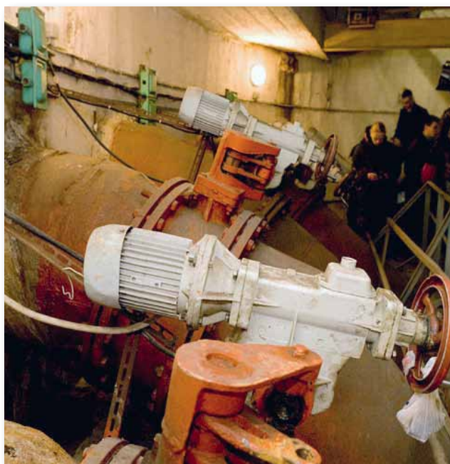
Sūkņu stacija Pļavnieki Ilūkstes ielā.
